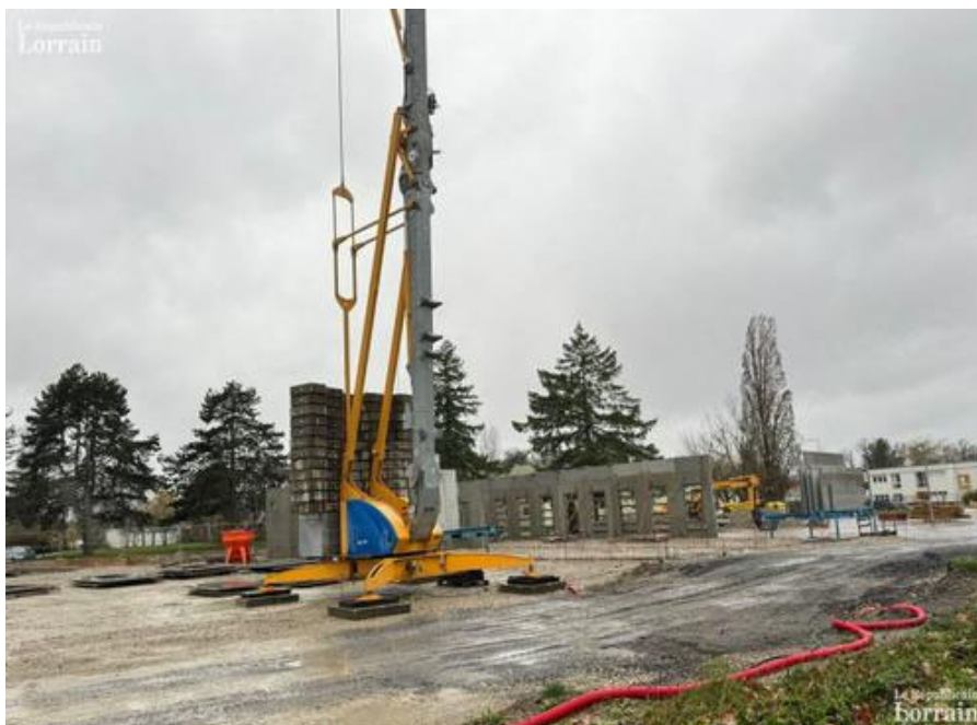
Le nouvel Ifsi est construit sur une partie de l'ancien parking du personnel. Le gros œuvre a démarré. Photo Aurélie Klein
