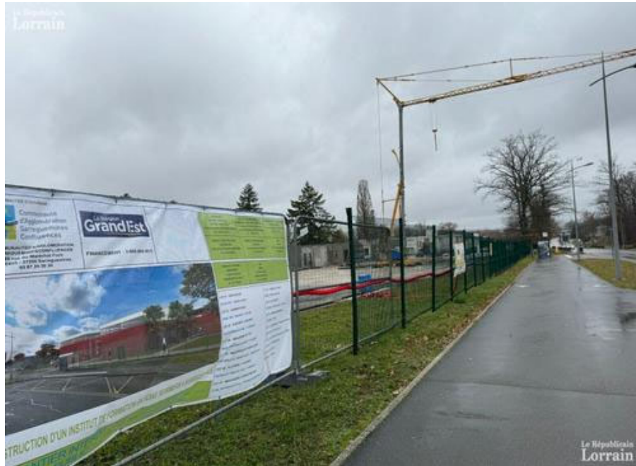
La construction du nouvel Ifsi est soutenue par la Casc et la région Grand Est. Photo A.K.
